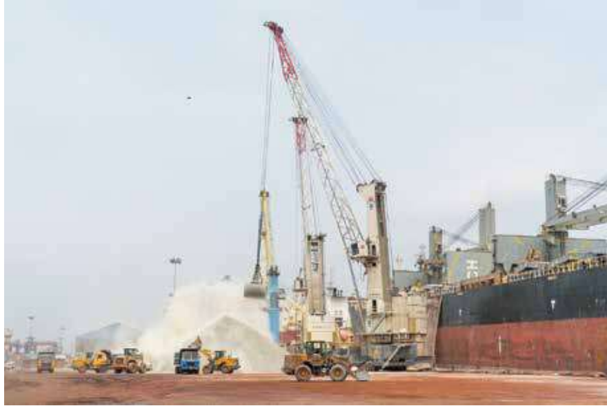
एचडीसी के बर्थ नं० 13 पर एमएचसी द्वारा उतारे जा रहे क्लीन कार्गो Clean cargo being unloaded by MHC at Berth No. 13 at HDC
